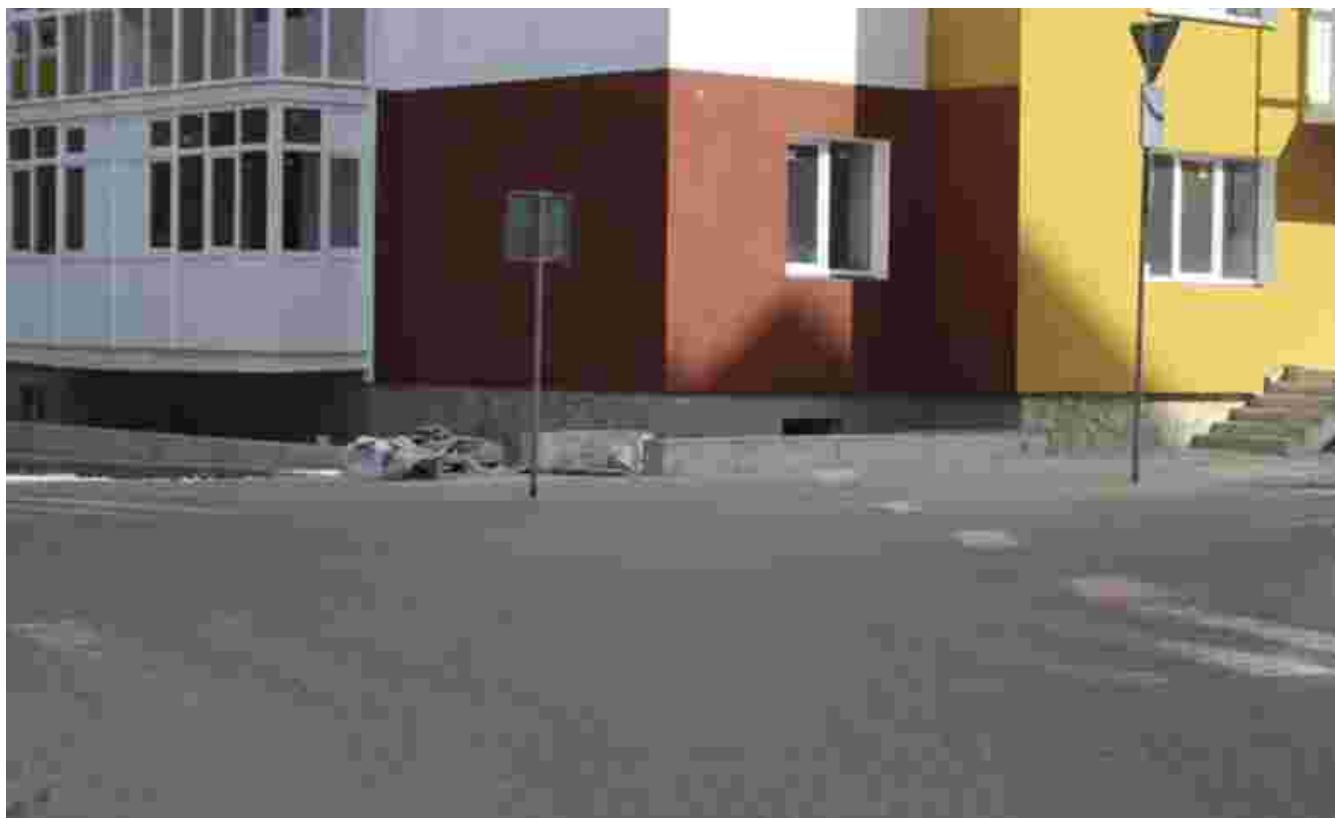
Фото 88: Практично зношена розмітка пішохідного переходу
